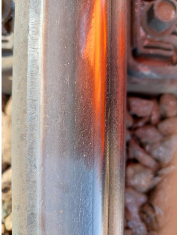
Трещины развивающиеся в продольном направлении в наружном рельсе
