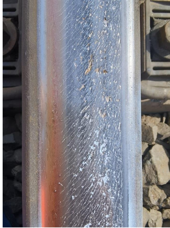
Развитые косые трещины во внутреннем рельсе, переходящие в выкрашивания
